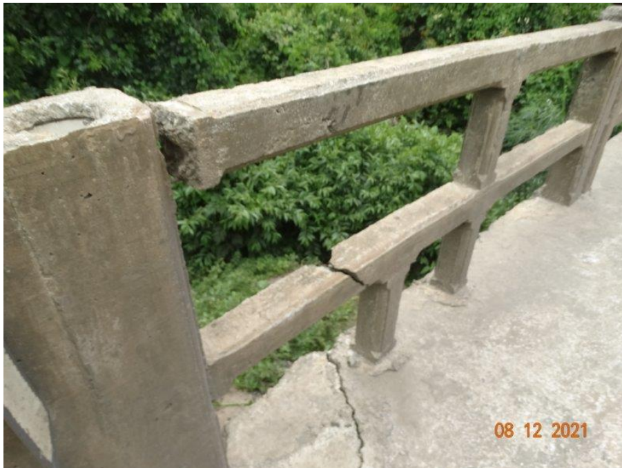
Foto 055 Ruptura do módulo 1 do guarda-corpos GC1.
