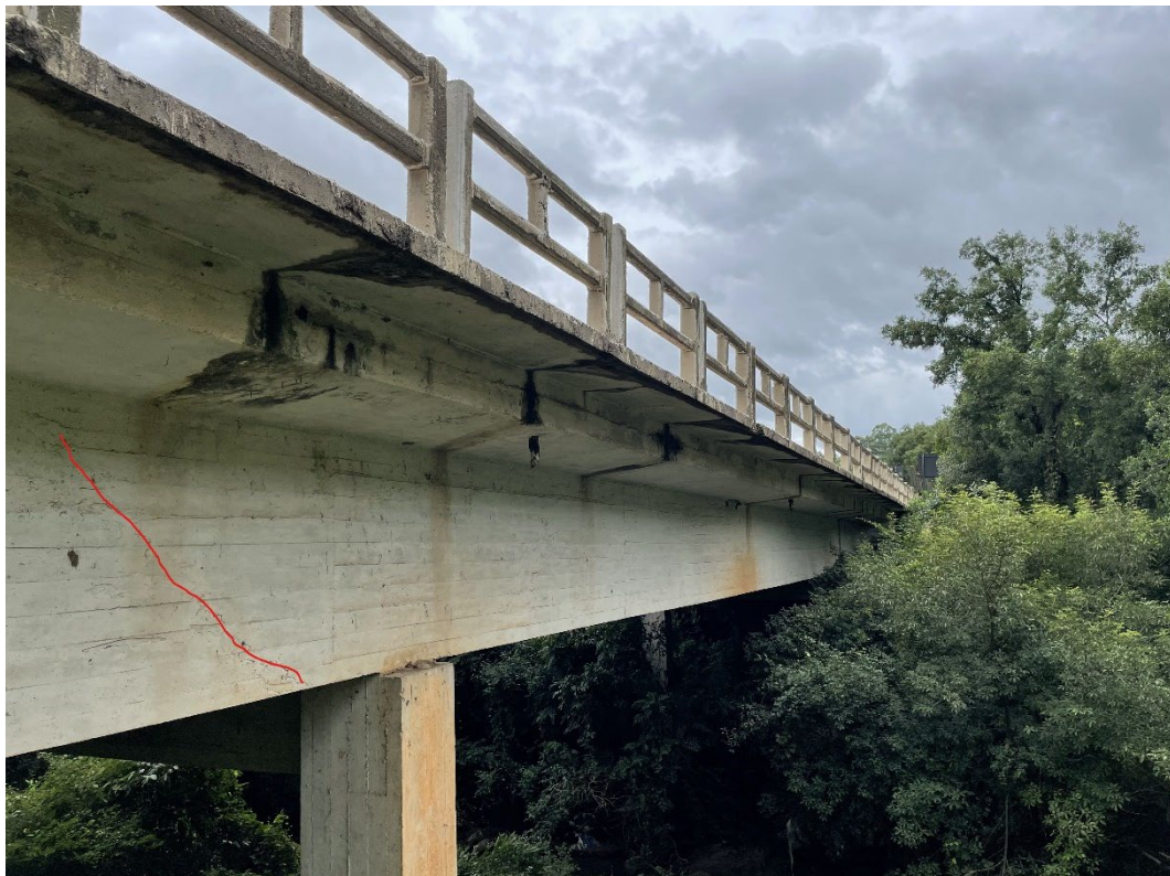
Figura 7 – Trinca na longarina
