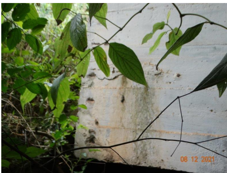
Foto 050 Concreto disgregado com armadura exposta e corroída na cortina CT1, face sul.
