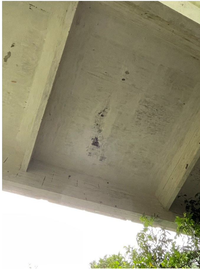
Figura 10 – Lixiviação do concreto na superestrutura
