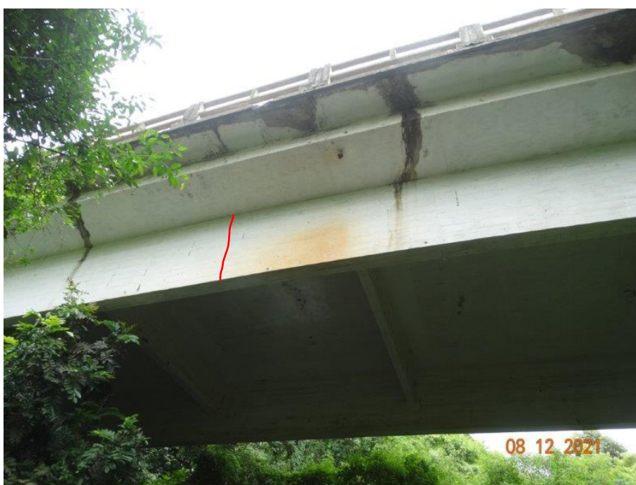
Foto 036 Fissura com posicionamento vertical e abertura \geq 0,3\text{mm} na viga longitudinal VL2, face oeste. Nota-se mancha de umidade na mesma.
