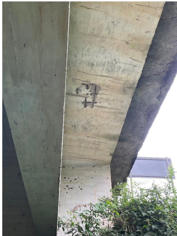
Figura 9 – Armadura exposta na laje
