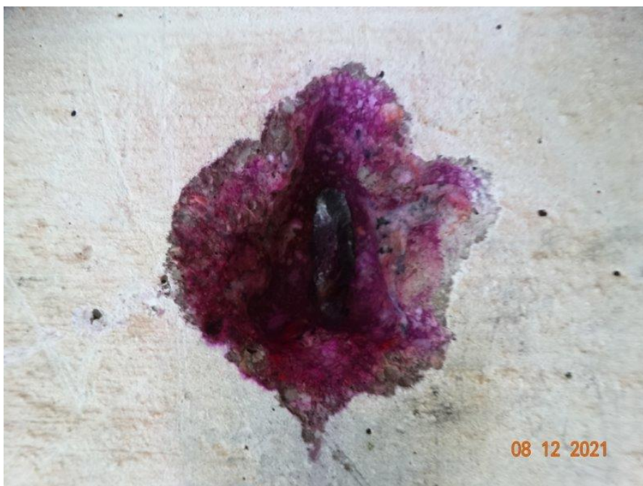
Foto 056 Ensaio para determinação da profundidade atingida pela carbonatação do concreto ao longo do tempo. Ponto 1 – Viga Longarina VL2, face leste – há 1,12 do encontro ENC1.
