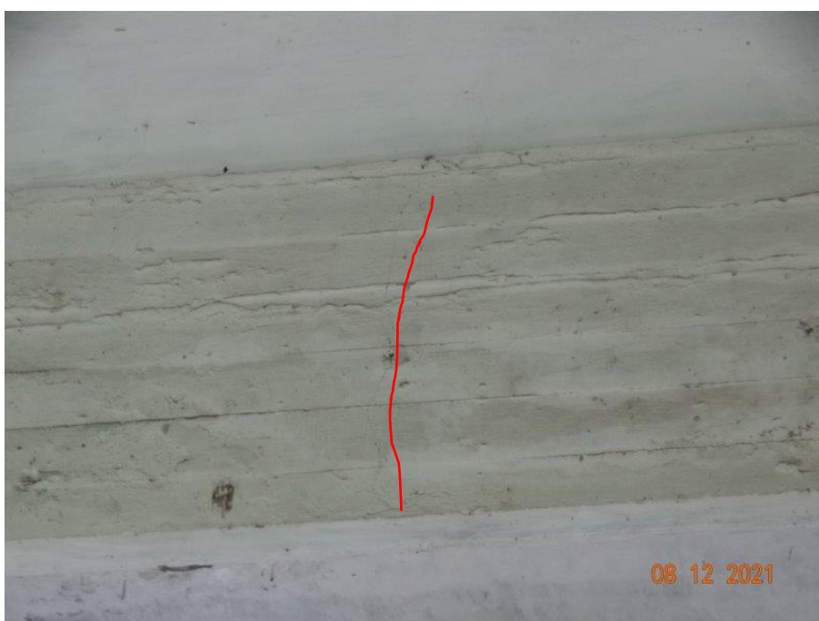
Foto 042 Fissura passante, com posicionamento vertical e abertura máxima de 0,3mm na viga transversina VT3, face sul.
