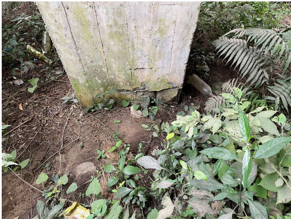
Figura 5 – Base do pilar com rompimento do concreto
